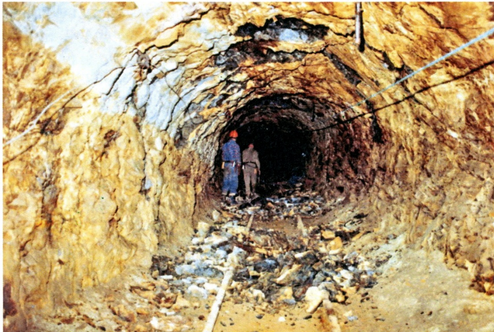
Foto 2.3.- Ejemplo de lajeo por Ravelling
