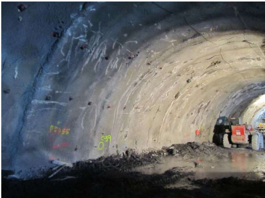
Foto 2.1.- Vista grietas sostenimiento por squeezing al paso de falla (Maximal closure del 8%)
