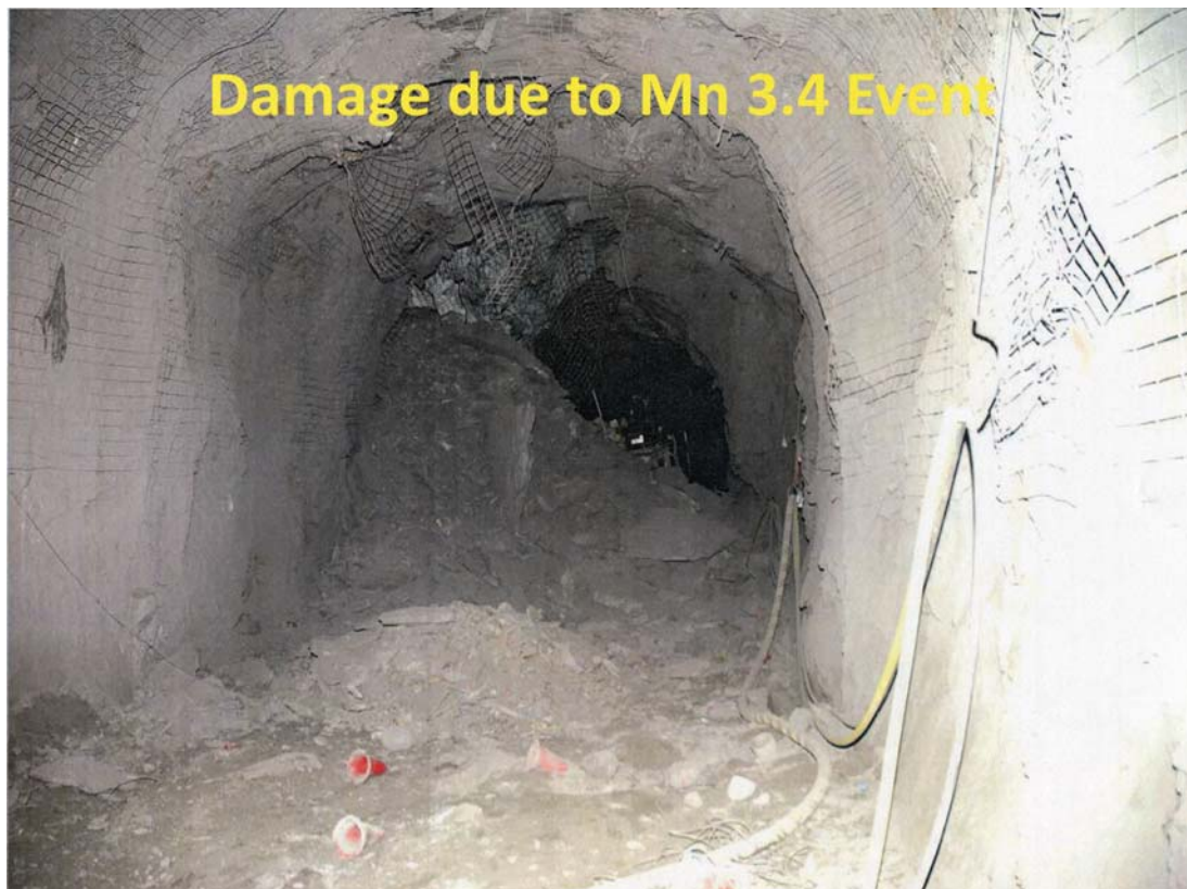
Foto 2.4.- Rock-bursting severo con caída cuña en hombro
