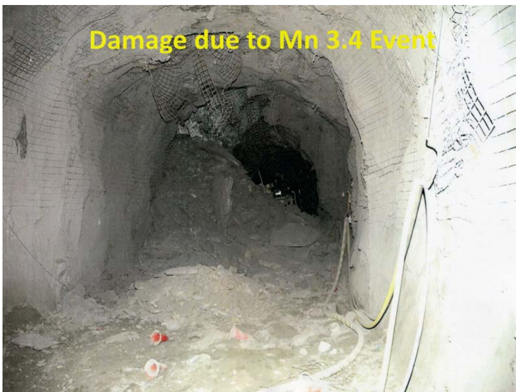
Foto 5.1.- Daños rotura galería por rock-bursting
