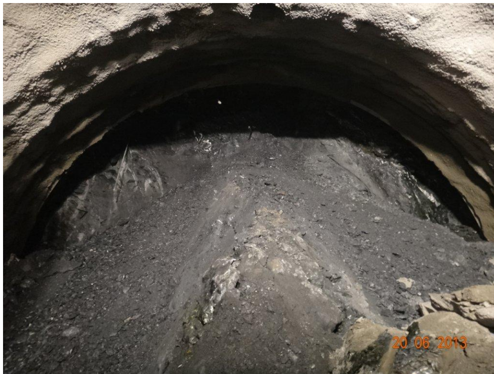
Foto 2.2.- Vista inestabilidad de frente con machón
