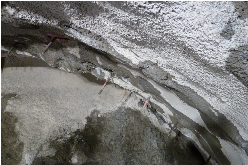
Foto 3.3.- Drenes para evacuación agua que filtre a la campana
