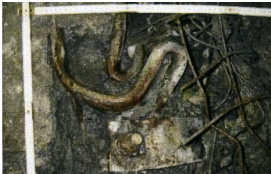
Foto 4.3.- Rotura soporte rígido squeezing en túnel Saint Martin La Porte
