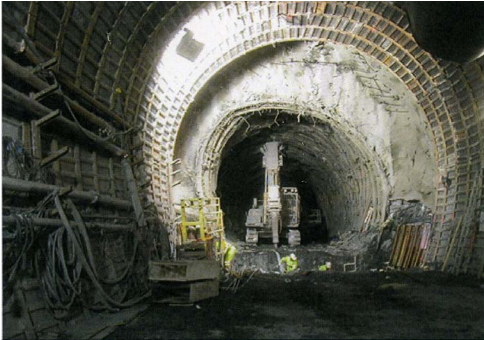
Foto 4.1.- Squeezing muy severo en túnel Saint Martin La Porte
