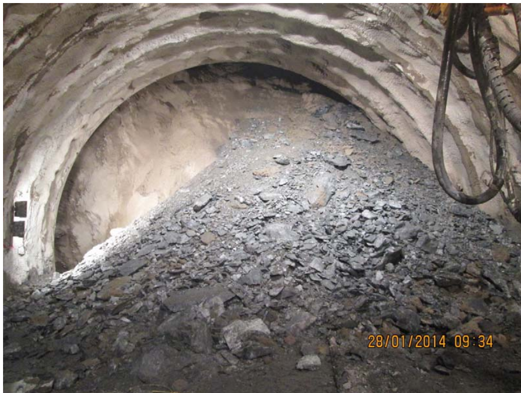
Foto 3.7.- Vista material desprendido de la campana.
