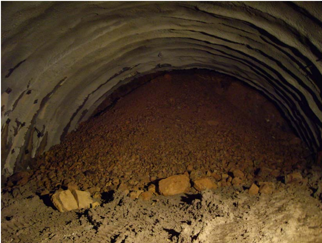
Foto 2.1.- Vista inestabilidad frente invadiendo el túnel
