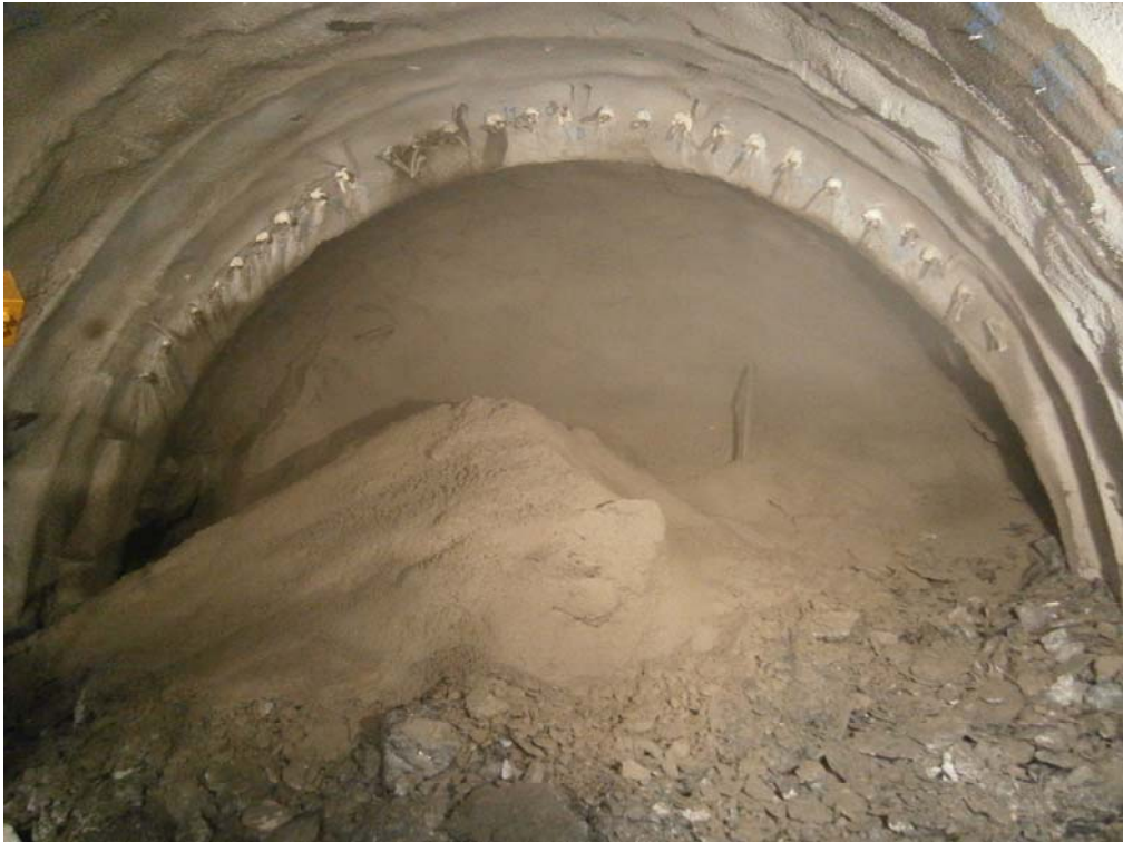
Foto 2.3.- Vista machón central en tramo túnel de frente inestable.
