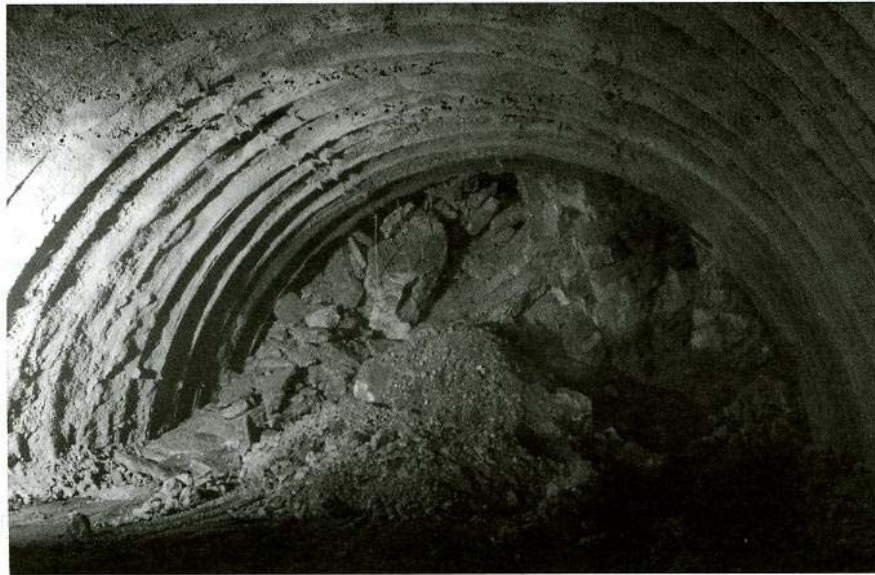
Foto 1 – Hundimiento frente en uno de los túneles ferroviarios del tramo Las Palmas-Oropesa (Castellón)
