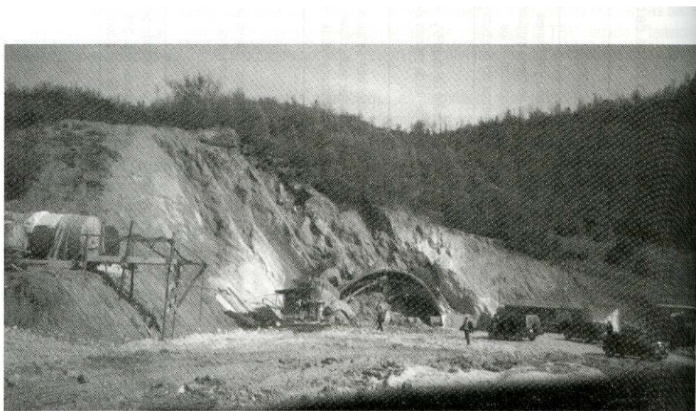
Foto 6.1 – Inestabilidad en emboquille
